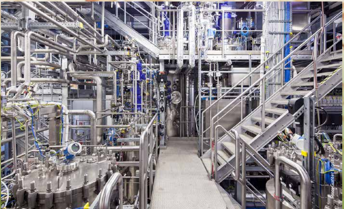
Die Demonstrationsanlage in Leuna bei Leipzig ist mit modernsten Technologien ausgestattet, um den Isobuten-Produktionsprozess zu entwickeln, bevor er in einer industriellen kommerziellen Produktionsanlage umgesetzt wird.
